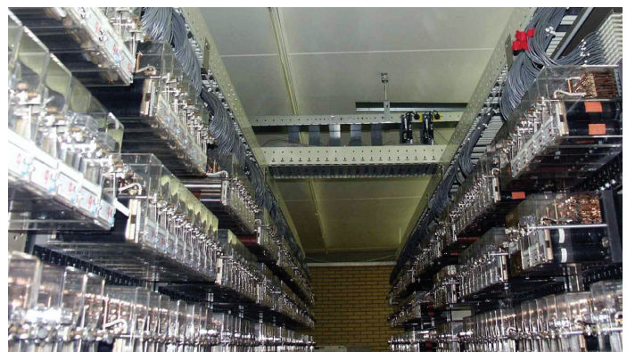
Bild 1: Ein voll ausgestatteter Relaisraum
